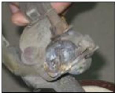
จุดต่อสายไฟฟ้าหลวม
